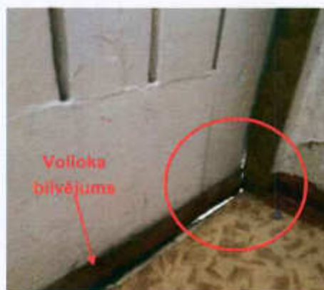
Vecās koka ārdurvis ar blīvējumu. Ir novērojamas spraugas
