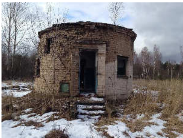
10.att. Izdemolēta un daļēji sabrukusi sūkņu stacijas ēka
